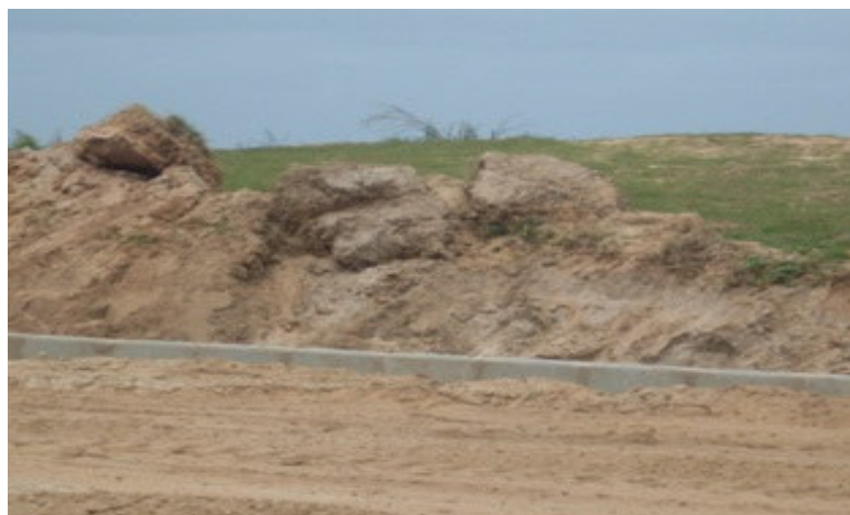
Figura2-Obra do calçamento no balneário de Guriri , realizada pela prefeitura Municipal de São Mateus/ES.
