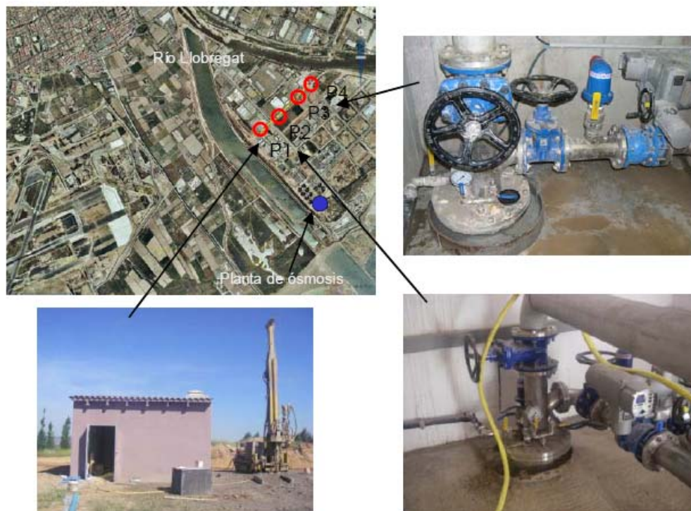
Figura. 3. Detalle de los pozos de inyección para la primera fase de la barrera contra la intrusión marina en el acuífero principal del Delta del Llobregat.
