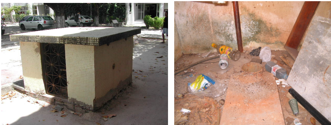
Figuras 10 e 11 - Abrigo do poço nº 01 (Departamento de Geologia) e poço sem a altura mínima de boca - Campus do Pici, Fortaleza.
