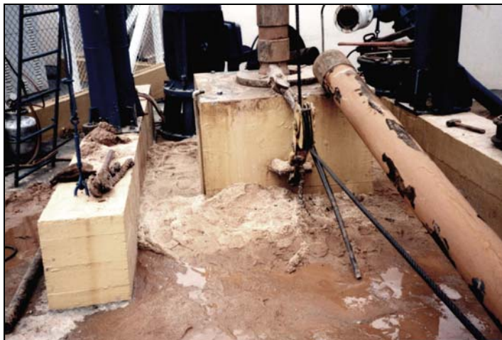
Foto 14. Poço produzindo muita areia e pré-filtro devido ao rompimento da coluna de revestimento.
