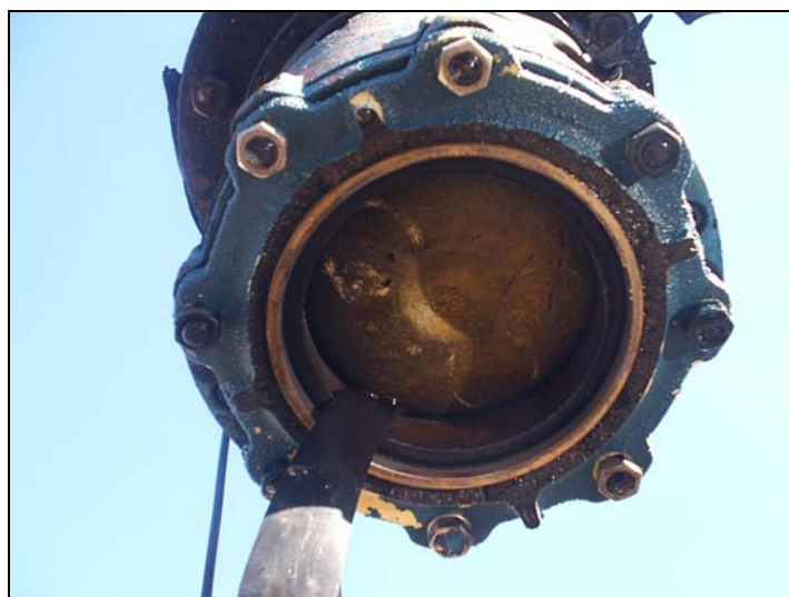
Foto 8. Vista da válvula de retenção da bomba submersa.
