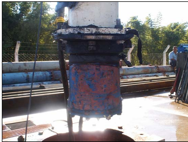
Foto 7. Tubo edutor juntamente com o flange de acoplamento para a bomba submersa. O bombeador e o motor caíram no poço com a queda.
