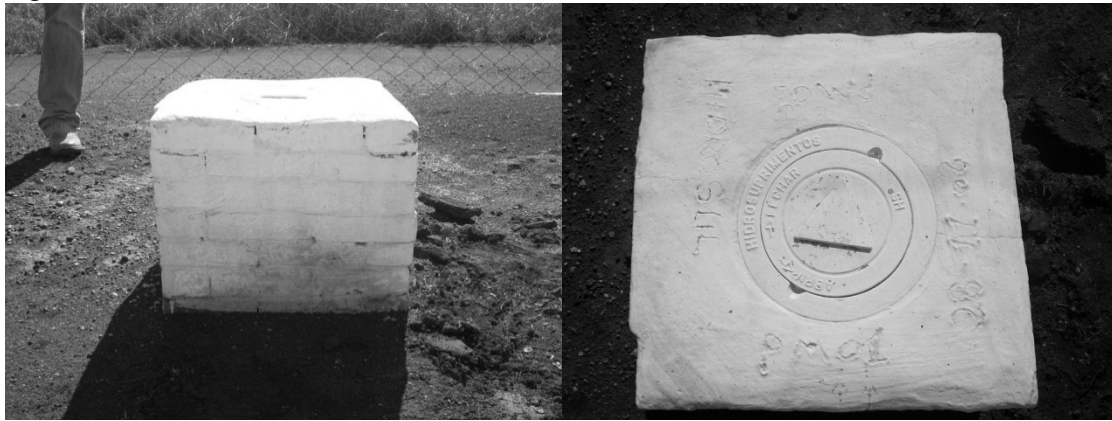
Figura 2 - Foto esquemática de um dos poços de monitoramento construído conforme a NBR n° 15495-1:2007.
