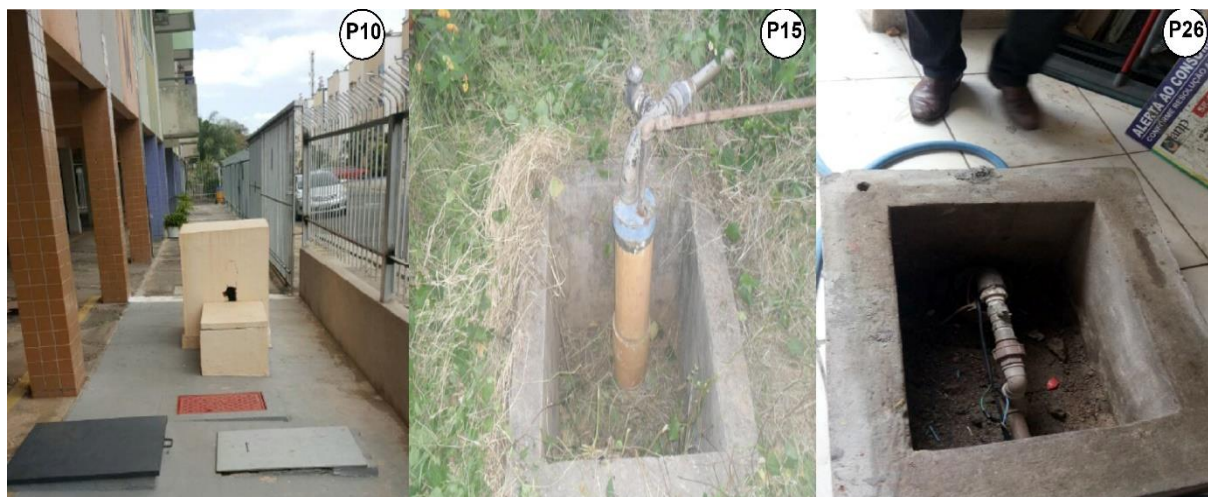
Foto 01 – Poços Tubulares, Bacia Hidrográfica do Rio Anil, São Luís – MA.
